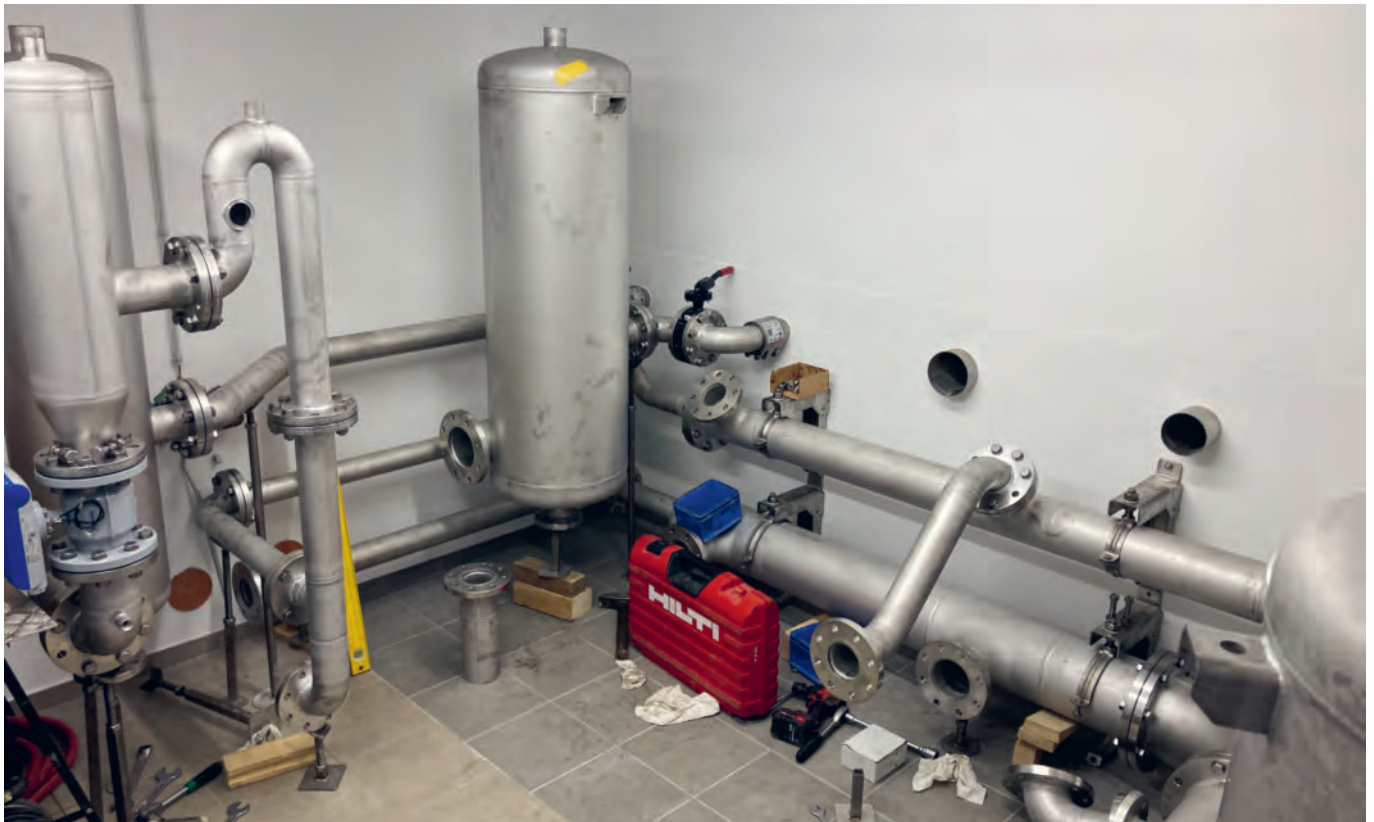
Jeder Quellzulauf wird mit Rohren gefasst. Das Quellwasser wird entlüftet, schwere Partikel setzen sich ab.
