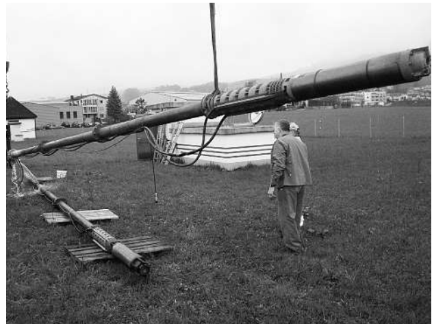
Lagerung der Pumpen 3 und 4
