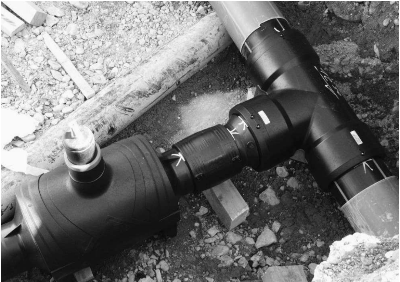
Hauptleitungen mit Kunststoffschieber
